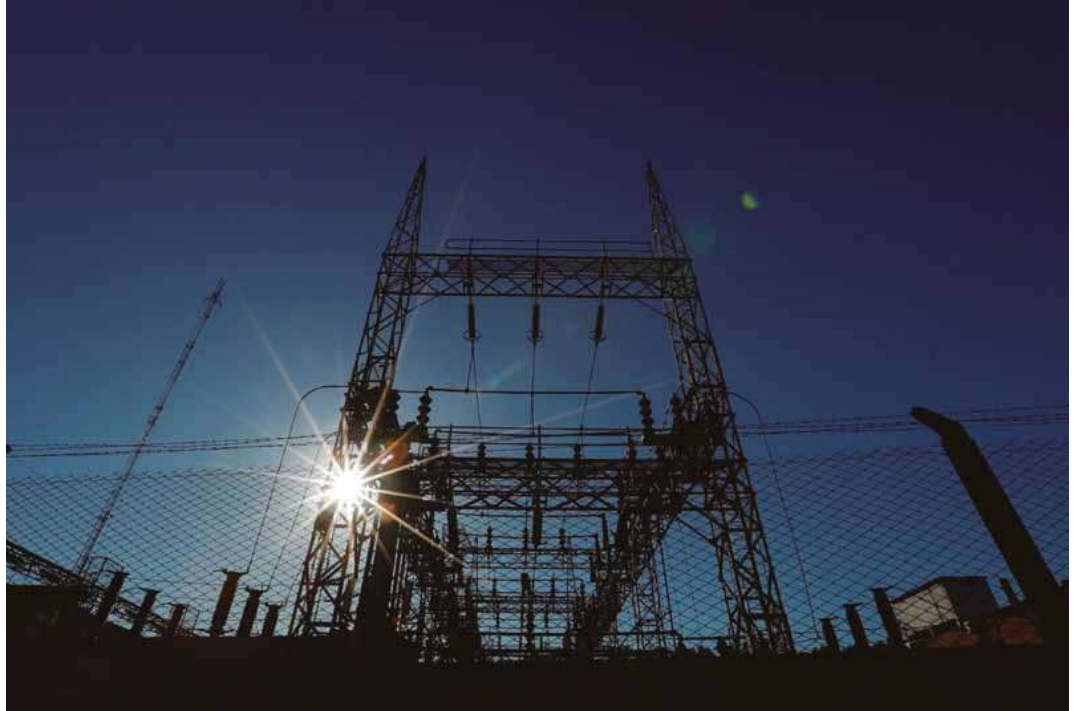
La nueva línea de alta tensión se extenderá a lo largo de 365 kilómetros. EFE
